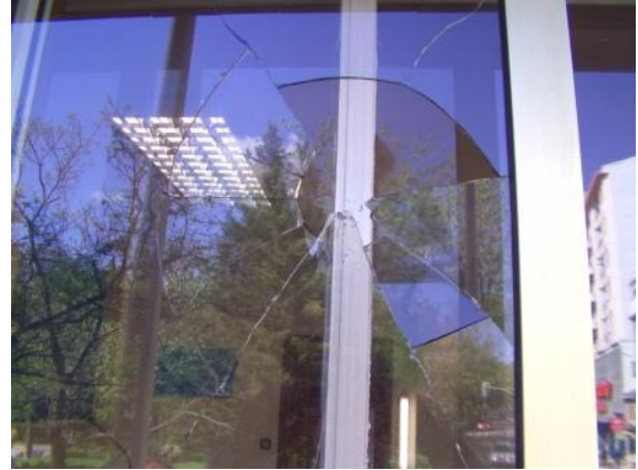
Destrozos sufridos en la fachada del PP
